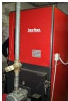
La caldaia a gas della scuola (150 kW).
