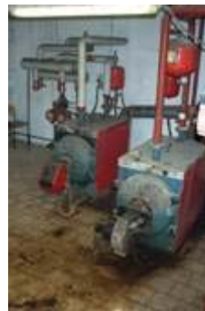
Le caldaie a gasolio del municipio (116 kW).
