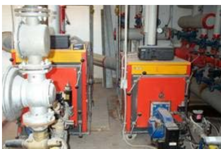
Le caldaie a metano esistenti.
